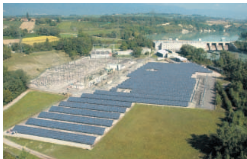
La centrale photovoltaïque SIG Solar 3, située près de Verbois.
