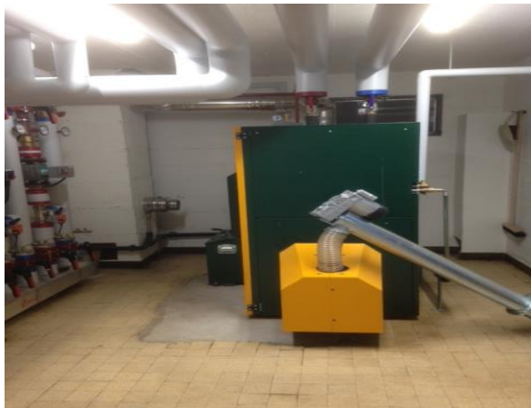
Chaufferie a pellet aux serres Bornaches bâtiment
