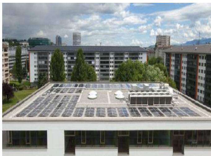
Installation solaire sur le toit de l'école de Chandieu
